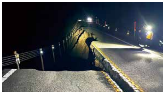
▲令和6年能登半島地震により陥没した道路
